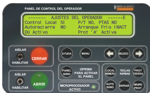
Panel de Control del Operador
