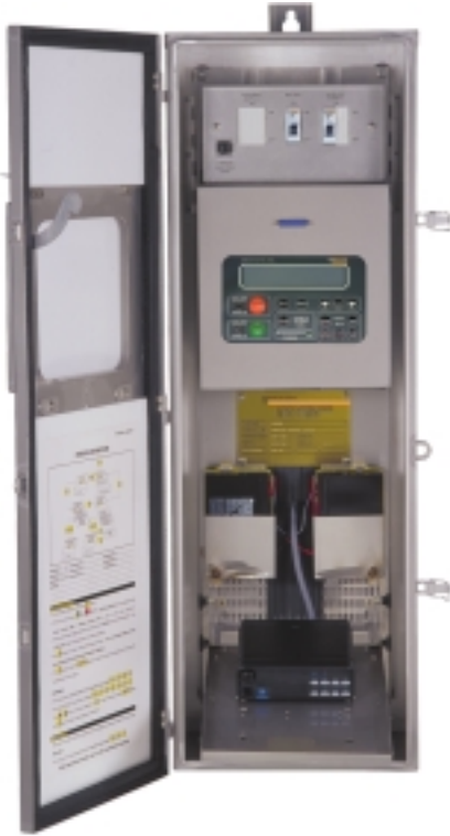
Gabinete de Control y Comunicaciones de Montaje en Poste
